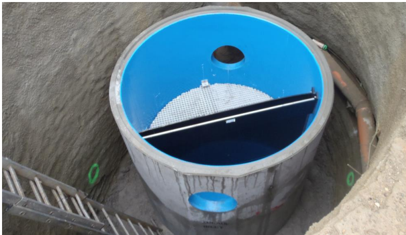
Bild 5 Standardsystem DN 2200 in Betonausführung, FiltaPex® · standard BE-2200 (hier: Märkischer Ring in Hagen, Inbetriebnahme am 16.06.2011)
