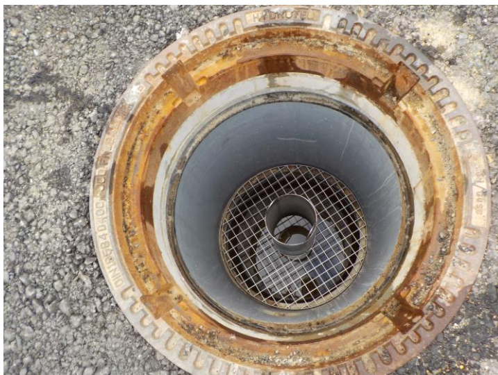
Bild 3 FiltaPex® · mini im Zustand ohne eingebautem Filter (hier: Wermelskirchen-Dabringhausen, Inbetriebnahme am 13.06.2017)
