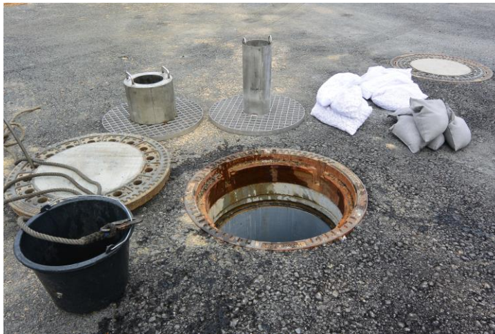
Bild 2 FiltaPex® · mini vor dem Filtereinbau für die Inbetriebnahme (hier: Wermelskirchen-Dabringhausen, Inbetriebnahme am 13.06.2017)
