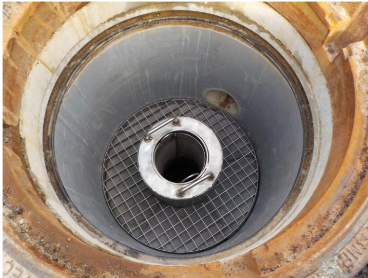
Bild 4 FiltaPex® · mini im Zustand mit eingebautem Filter und Auftriebssicherung (hier: Wermelskirchen-Dabringhausen, Inbetriebnahme am 13.06.2017)
